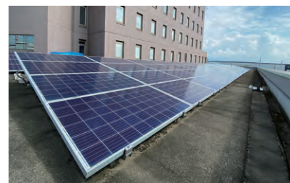
ALSOK群馬本社屋上の太陽光パネル
