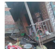
倒壊した現地社員自宅
