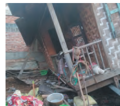
倒壊した現地社員自宅
